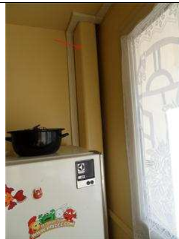
025 - Appartements - Cuisine LOT 0201 PH15 : amiante ciment
